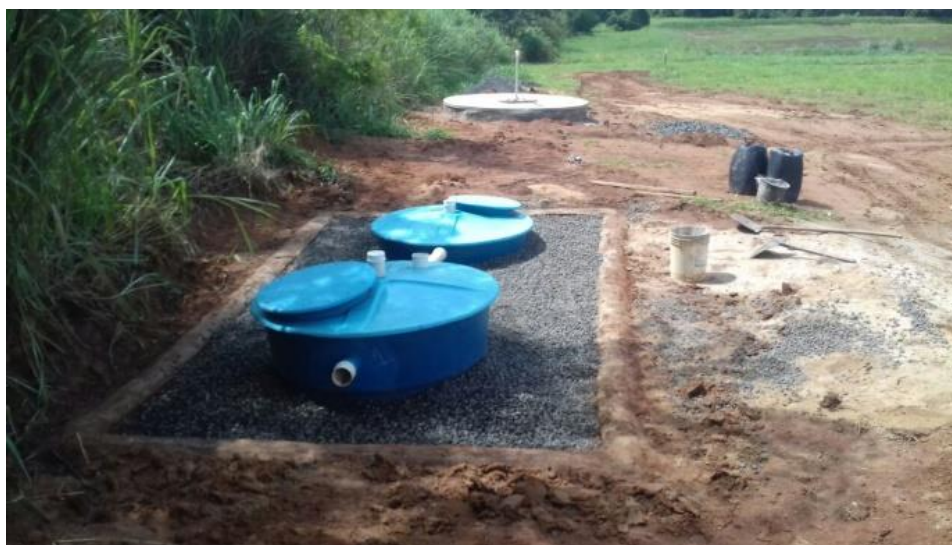
Figura 5 - Modelo de fossa sanitária instalada em empreendimento de mineração no estado de São Paulo (2018).
